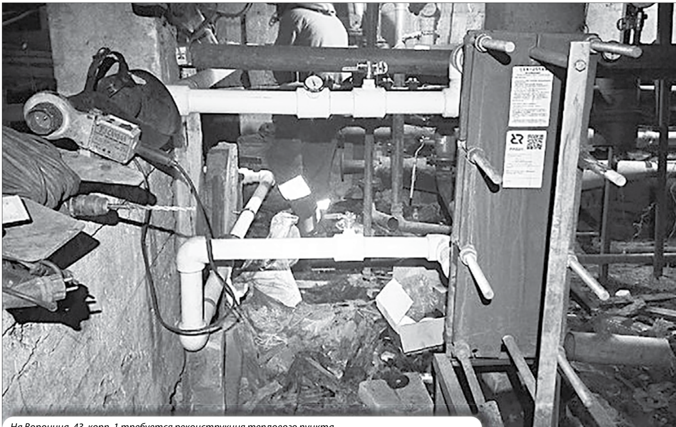
На Воронина, 43, корп. 1 требуется реконструкция теплового пункта.
