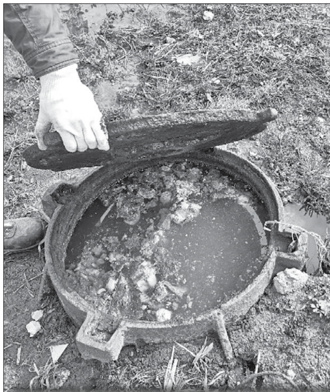
Переполненный колодец на Тимме, 18
