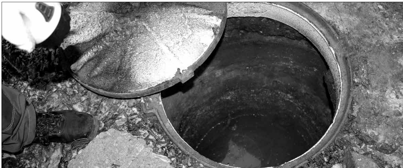
Если канализационные колодцы переполнены, стоки идут прямоком в подвалы близлежащих домов.
