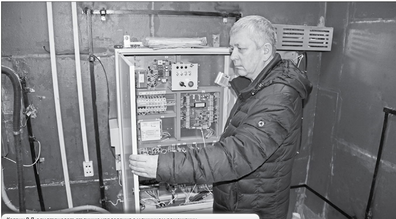
Корзин В.Л. осматривает станцию управления в машинном помещении.
