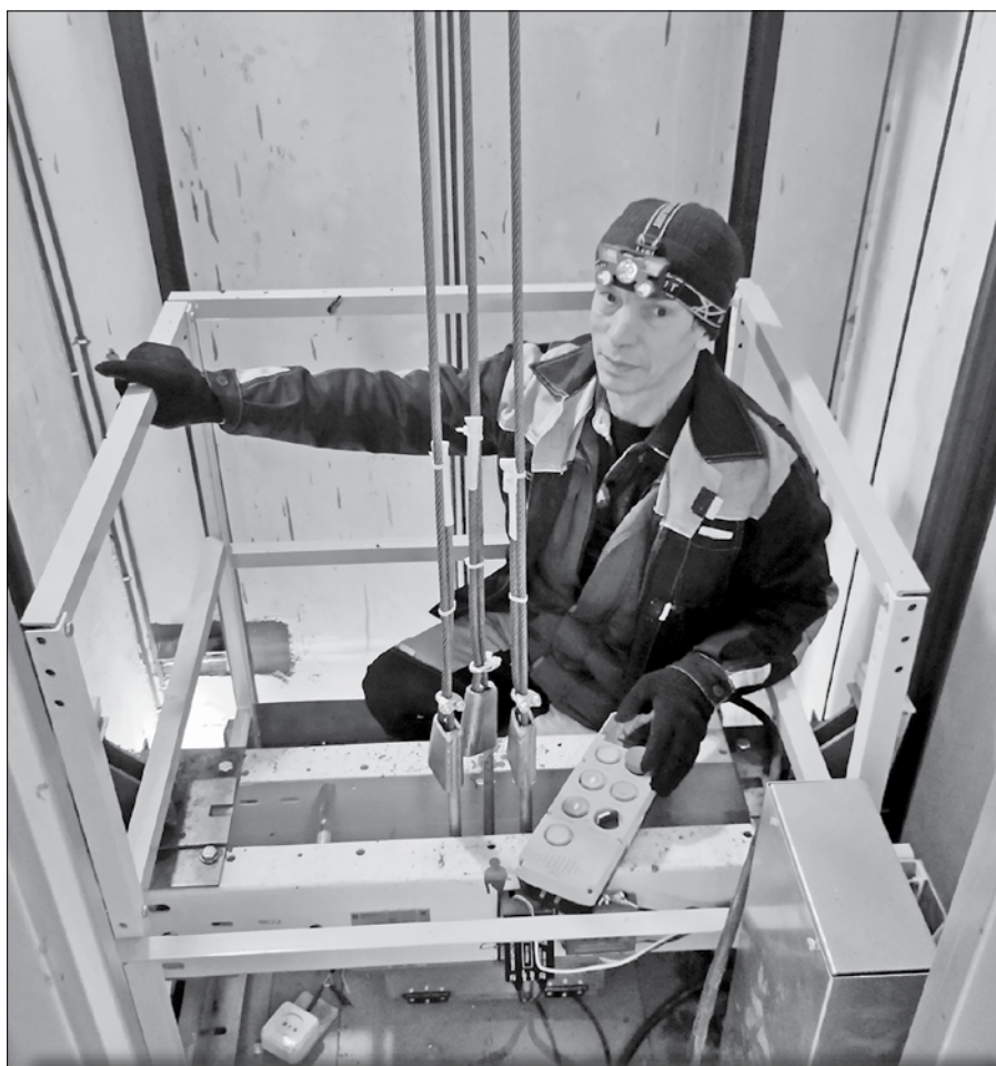
Электромеханик по лифтам Томаровский Н.Е. производит настройку блока дверного привода на Воронина, 39. Новые подъёмники в доме смонтировали в конце 2023 года.
